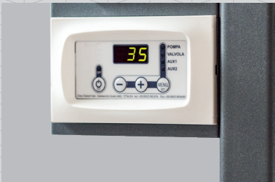
Unité de contrôle synoptique (surveillance du système)
